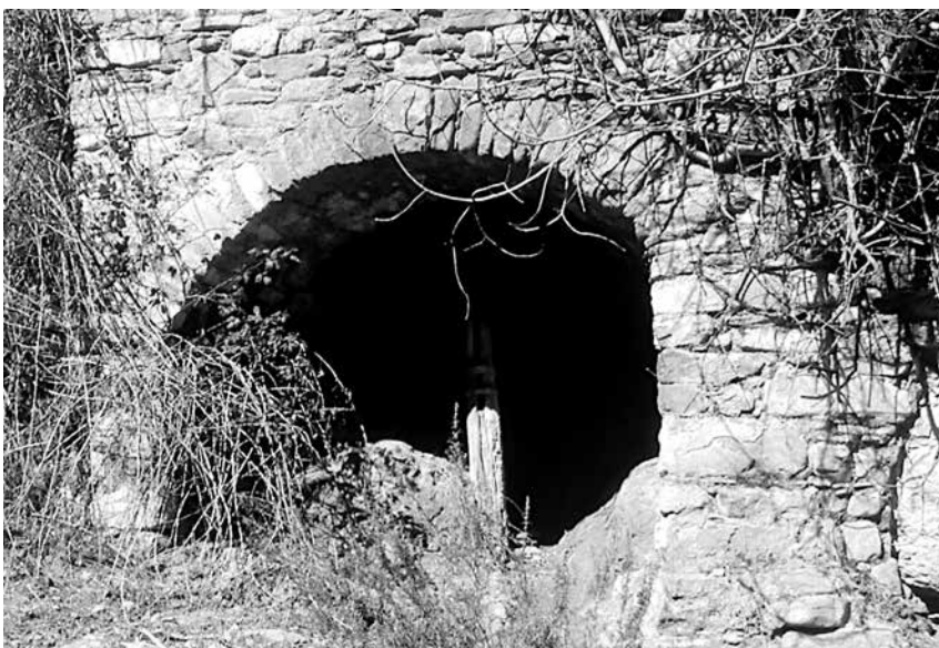
El arco del cárcavo no es simétrico.
