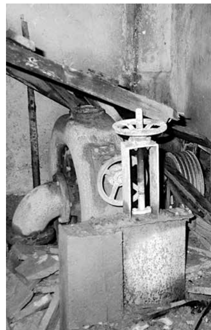
Turbina en cuarto separado — 5
